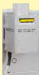
Chimney with fan
